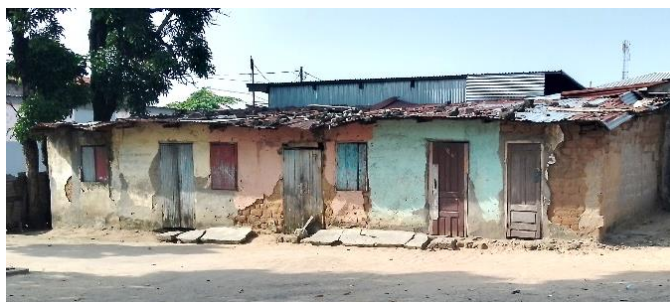
Photo 1 : Habitations traditionnelles délabrées. Cliché Nzoumba, 2024
