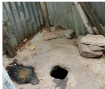
Photo 4 : Latrines rustiques avec une fosse septique béante. Cliché Nzoumba, 2024
