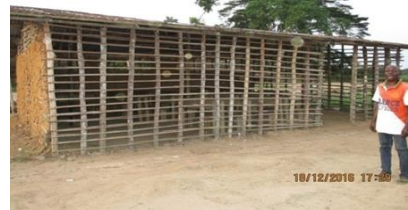
Photo 3 : bâtiment scolaire du CEG inachevé à Ello. Prise de vue Etoura-Iloky, 2016
